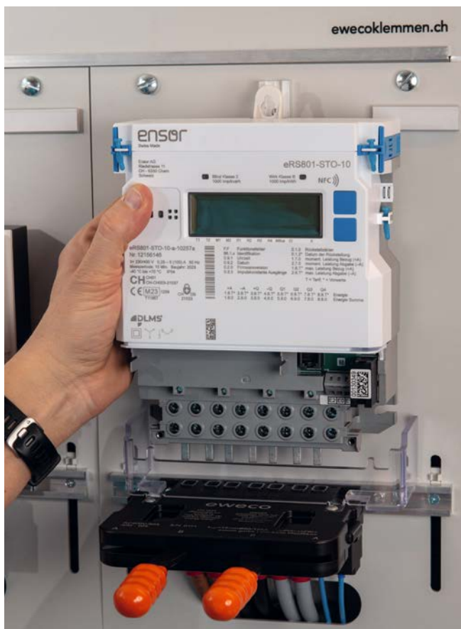
Der Zählerwechsel gilt mit der neu konstruierten Klemme als «Bedienen» und eine persönliche Schutzausrüstung ist nicht mehr nötig.
